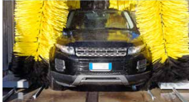
Impianti di lavaggio
